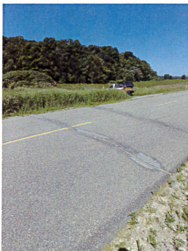
Photo 6 : Déformation de la chaussée
