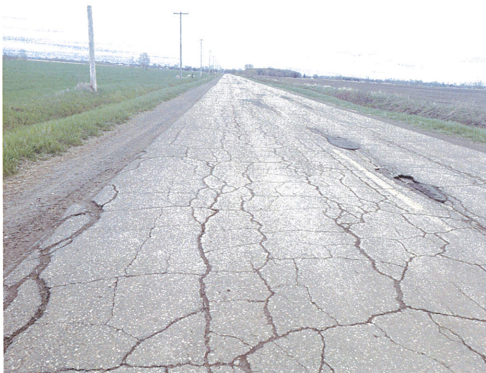
Photo 3 : Fissures transversales et longitudinales – affaissement de la chaussée
