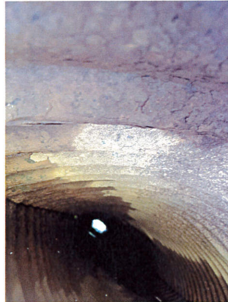
Photo 15 : Présence de corrosion au niveau de la couronne du ponceau – perforation du radier très probable
