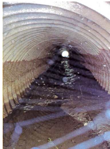
Photo 10 : Présence de corrosion et de perforation au niveau du radier
