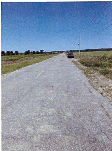
Photo 9 : Déformation de la chaussée
