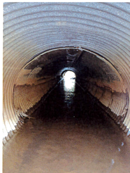
Photo 28 : Vue en amont – Corrosion, radier perforé, joints ouverts
