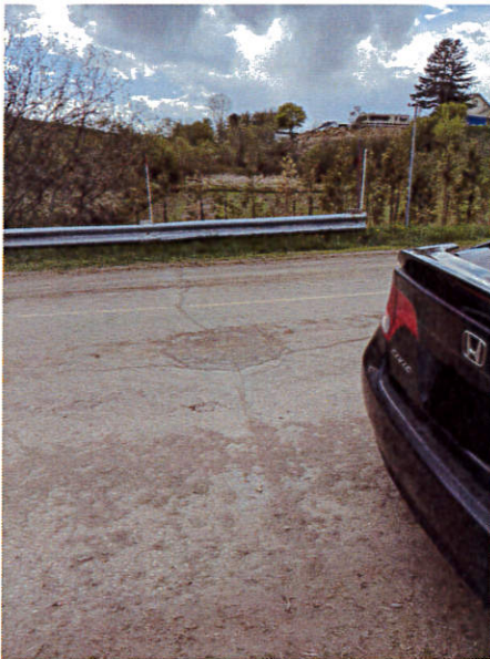
Photo 25 : Déformation de la chaussée, affaissement récurrent au droit du ponceau
