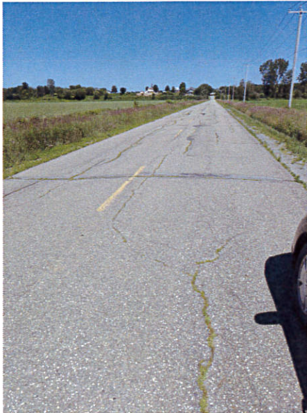
Photo 14 : Déformation de la chaussée
