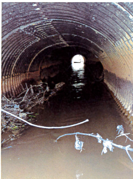
Photo 27 : Vue en amont – Corrosion, radier défoncé, joints ouverts
