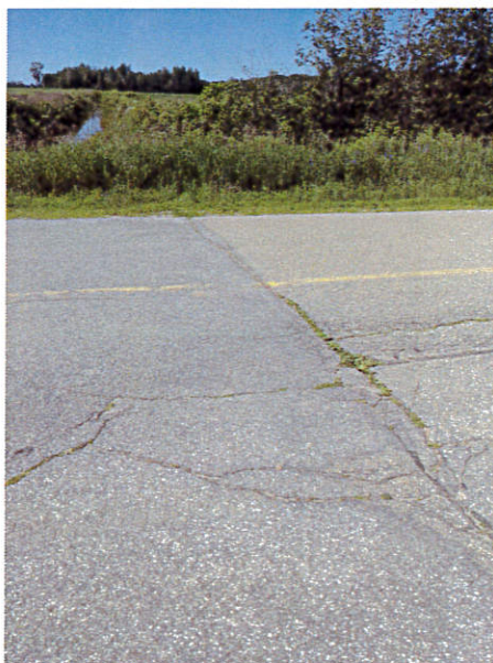
Photo 17 : Déformation de la chaussée
