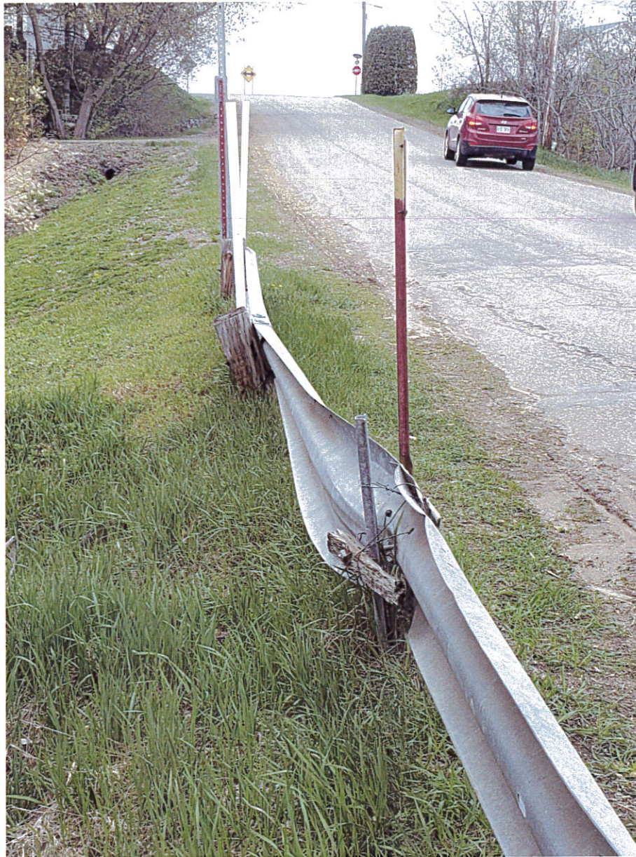
Photo 5 : Chaînage 2+390 – Glissière de sécurité existante à remplacer
