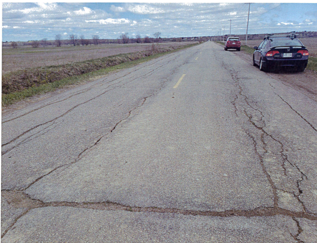
Photo 1 - Fissures transversales et longitudinales - ornières et affaissement de la chaussée
