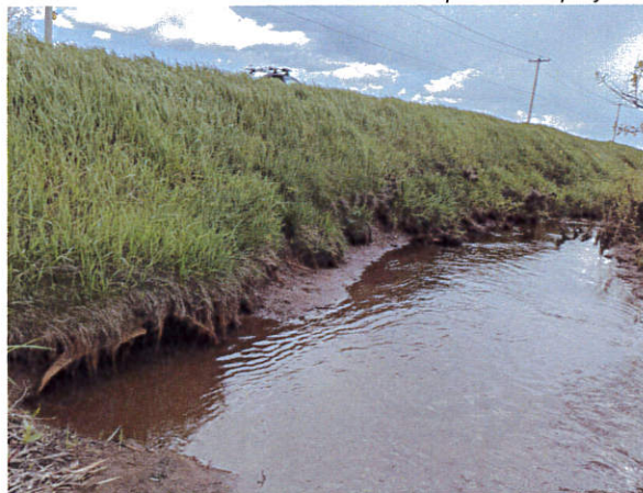
Photo 16 : Ponceau enfoui à 75%
