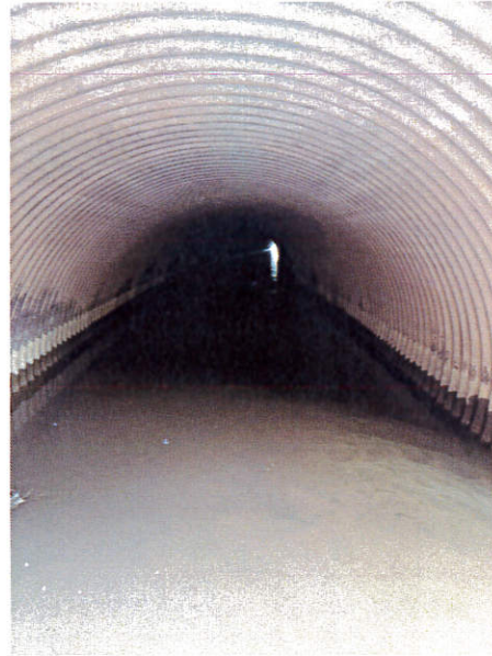
Photo 22 : Légère présence de corrosion – déviation de sa trajectoire à mi-parcours pour éviter la pile du pont
