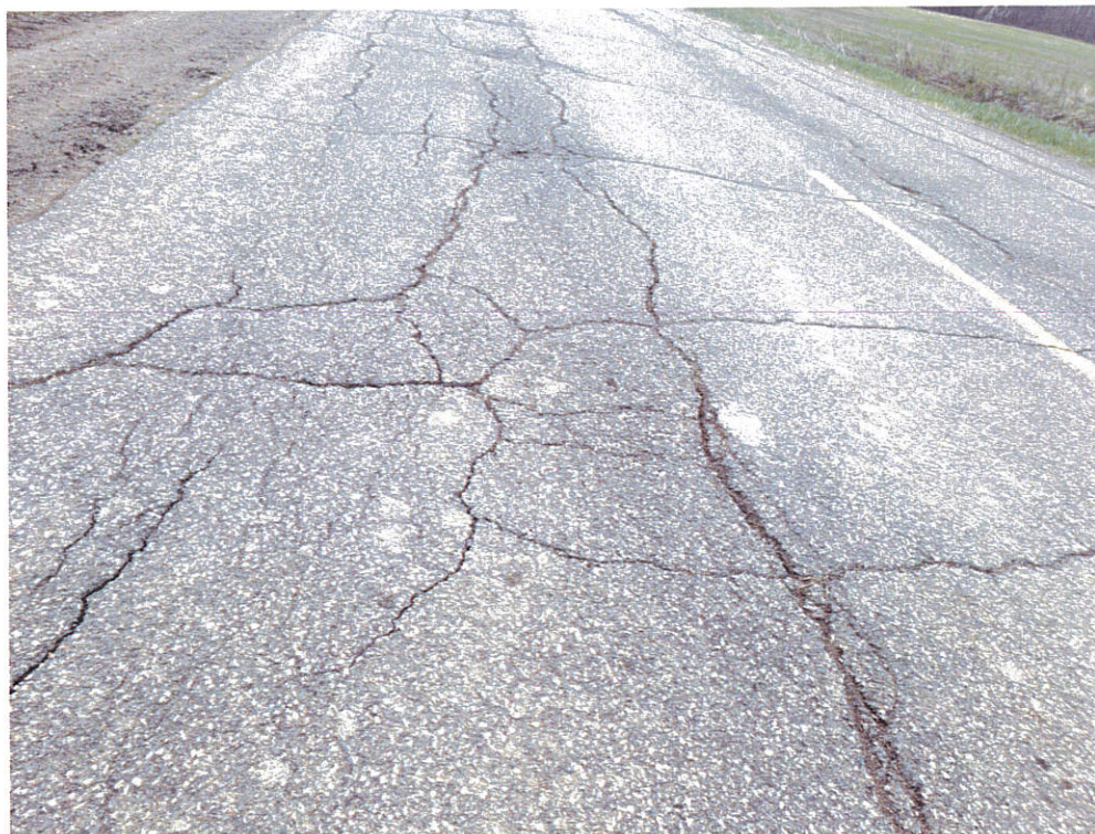
Photo 2 : Fissures transversales et longitudinales
